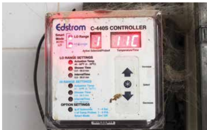
IMAGEM 3 ▲ Caixa de Controlo do sistema Cooling.
